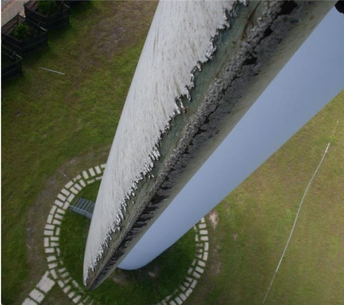
Erosion der Blattvorderkante eines Rotorblattes. Quelle: Windindustrie in Deutschland (2024)
