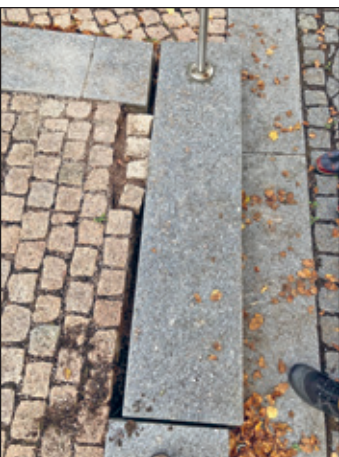
Die große Granitstufe am Informationspunkt wurde durch minutenlanges bewusstes Hantieren am Geländer aus dem Pflasterverbund herausgebrochen. (Foto: SV)
