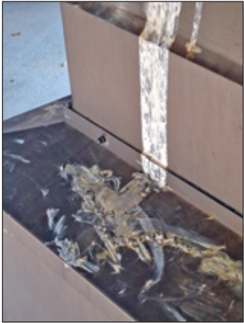
Der gesamte Innenraum wurde beschmier.
